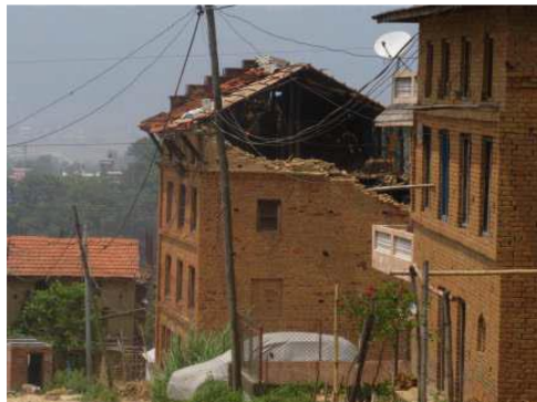
Figure 85 മട്ടച്ചുമരുകളുടെ തകർച്ച സ്രോതസ്: Training of Masons on Hazard-Resistant Construction, NDMA
